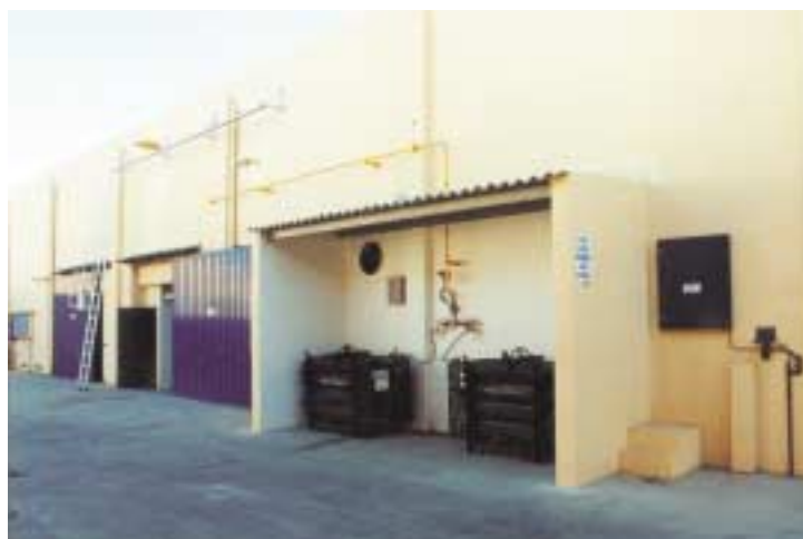
Depósitos de Gas Nitrógeno inertizante.
