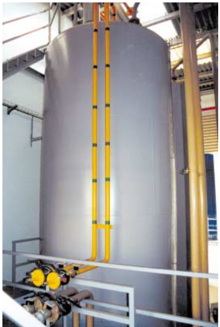
Tanques de proceso de Poliisocianato Aromático en solución y Poliuretano Aromático en solución (dos tanques con capacidad de 30.000 litros cada uno).
